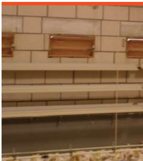
Deltabuizen vast gemonteerd onder de inlaatventielen.
