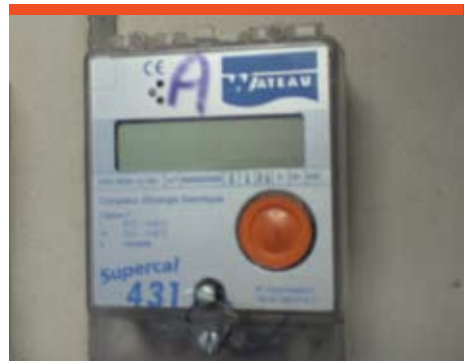
Om het energieverbruik te meten werden calorimeters geplaatst.
