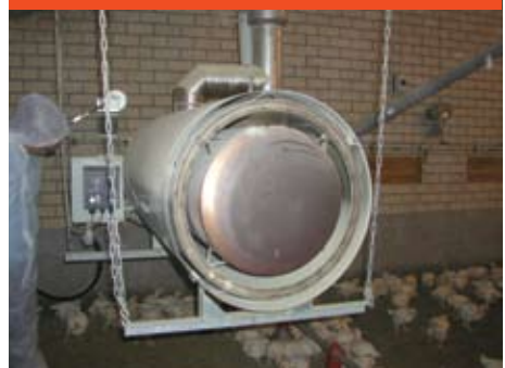
Een gesloten verbrandingsruimte bij het warmtekanon met afvoer van rookgassen.
