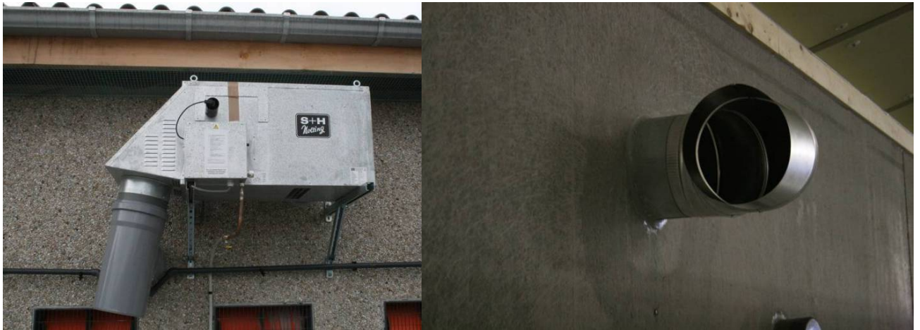
Figuur 22 Directe verwarming met brander buiten de stal en uitlaat in de stal
