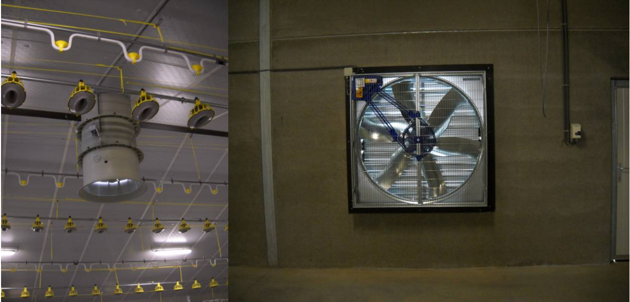
Figuur 14 Dakventilator en lengteventilator in dezelfde stal
