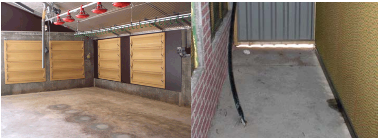
Figuur 9 Padkoeling: links de inlaatopeningen voor de gekoelde lucht gezien vanuit de stal, rechts dezelfde inlaatopening vanuit de buitenkant en de eigenlijke pad waardoor de lucht de gang binnenkomt (rechts op de rechtse foto) (Bron: Boerderij)
