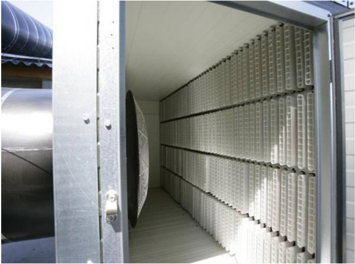
Figuur 11 De verse lucht komt binnen via de lamellen (rechts) en wordt door de buis naar de stal gebracht, de warme lucht gaat langs de lamellen naar buiten (Bron: Boerderij)
